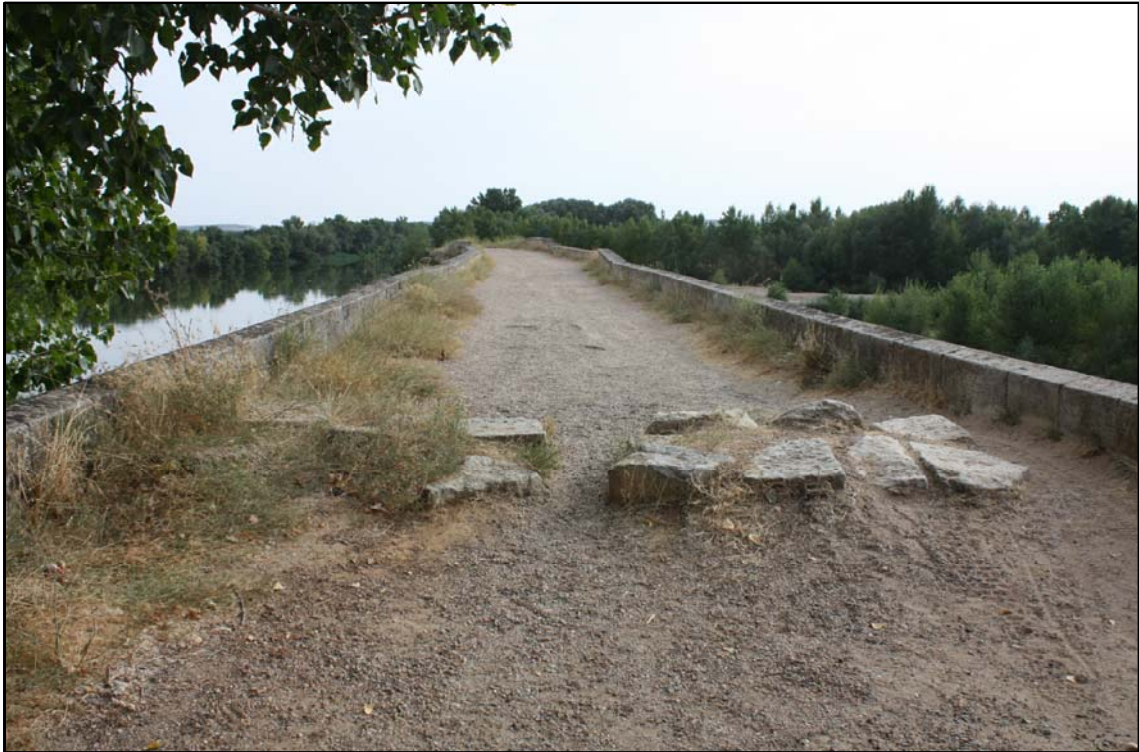
Foto N°9: Vista del inicio del puente en el lado norte, hacia el sur, con ausencia de pavimento en su tablero, y unas piedras a modo de bolardos que impiden el paso rodado.
