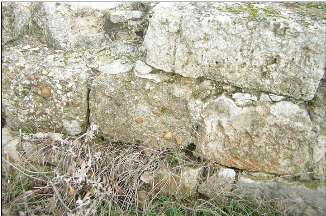
Foto N°10: Detalle del estado de algunos de los pretilos existentes en el puente en su mitad norte.
