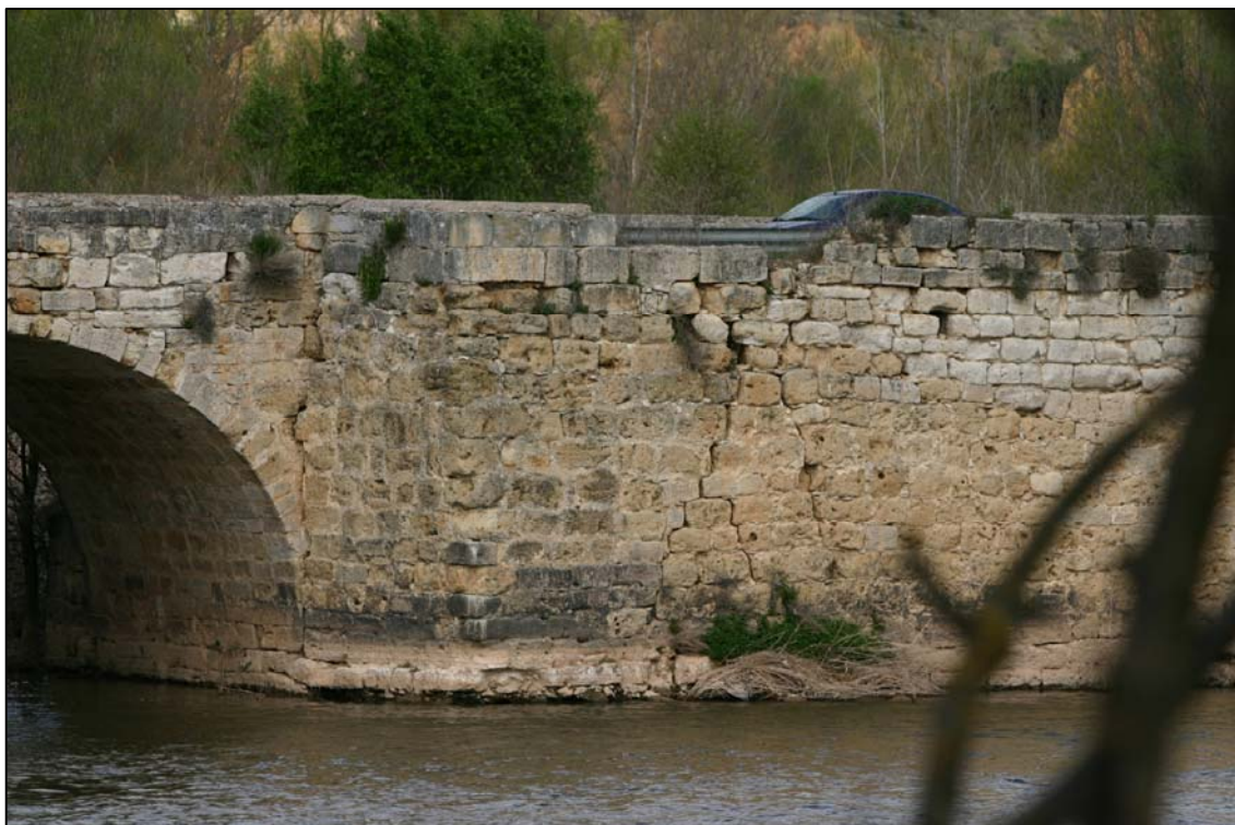
Foto N°21: Vista aguas arriba del puente en su desembarco sur, en el muelle entre el tramo principal y el llamado de Los Cinco Pilares. Se aprecian grietas de separación del ángulo saliente a partir del arranque del arco al sur y en el lienzo del muro al norte.
