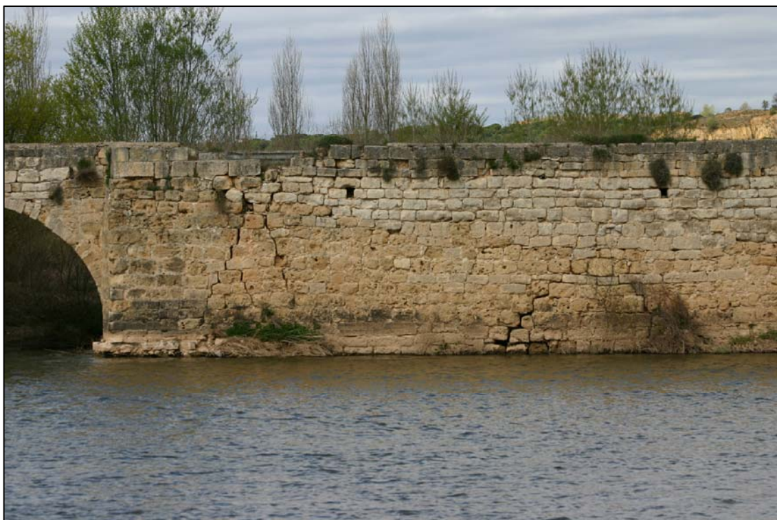
Foto N°22: Vista frontal del muelle entre el tramo principal y el llamado de Los Cinco Pilares. Se aprecian grietas de rotura cerca de la esquina saliente a la izquierda, y grietas por asientos, debidos probablemente a descalces en la cimentación, en la parte media, a la derecha de la foto, todo ello debido al empuje del agua en la base.
