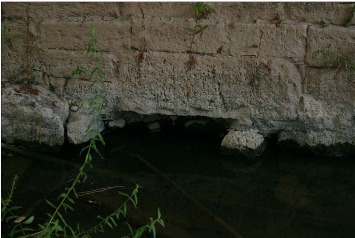
Fotos N°17 y 18: Detalles, en la base de la pila entre los arcos I y J, en las que se observa las faltas y oquedades en el interior de la misma, con lavados muy importantes de rellenos interiores, y comunicación, o invasión de agua desde el exterior.
