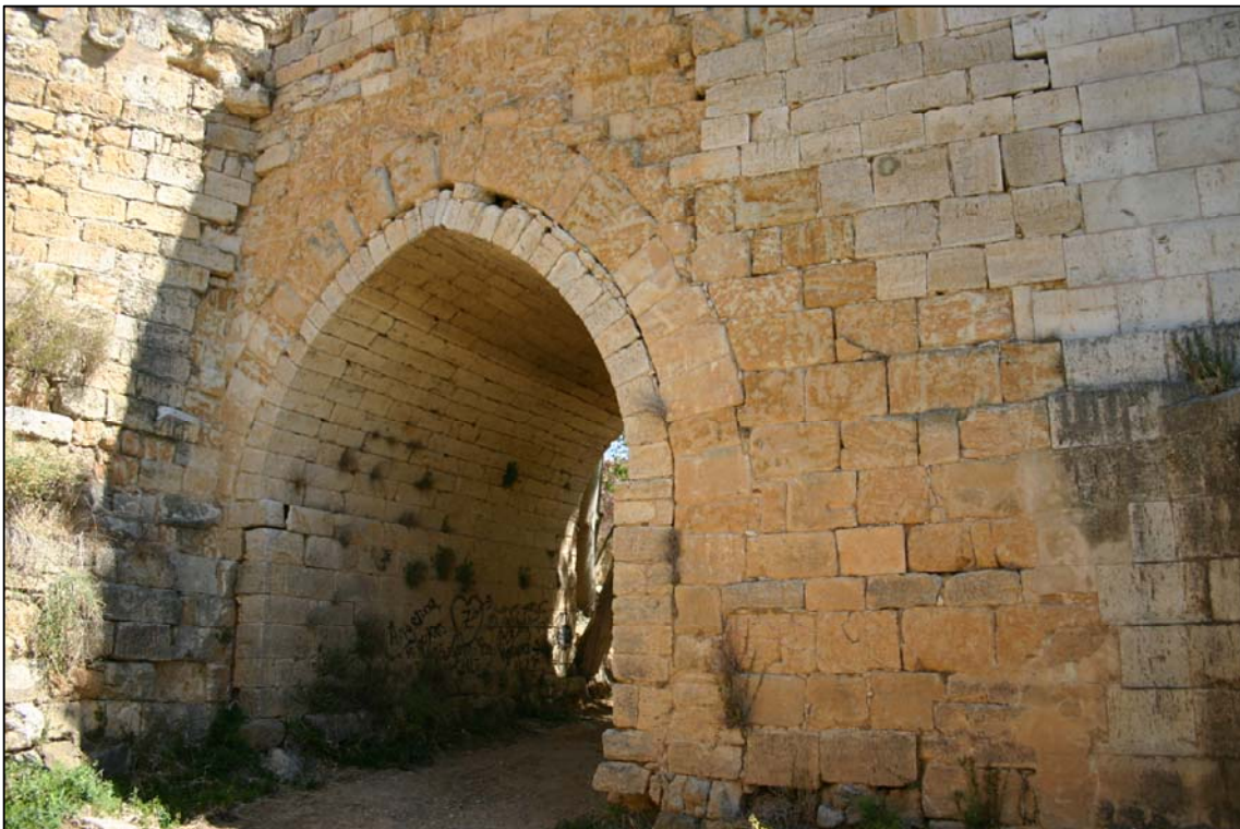
Fotos N°13 y14: Arco A (primero desde la orilla norte), con el refuerzo de piedra caliza realizado bajo la rosca de arenisca de la fábrica original. Se aprecia en el apoyo izquierdo una grieta que recorre en vertical toda la unión, manifestando defectos en el apoyo de todo el elemento.
