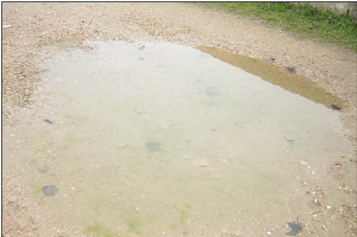
Fotos Nº7 y 8: Formación de charcos en el tablero del puente, con retención de aguas que posteriormente van filtrándose por los rellenos de las enjutas, lavándolos, arrastrando sales y provocando daños en rellenos y fábricas inferiores.
