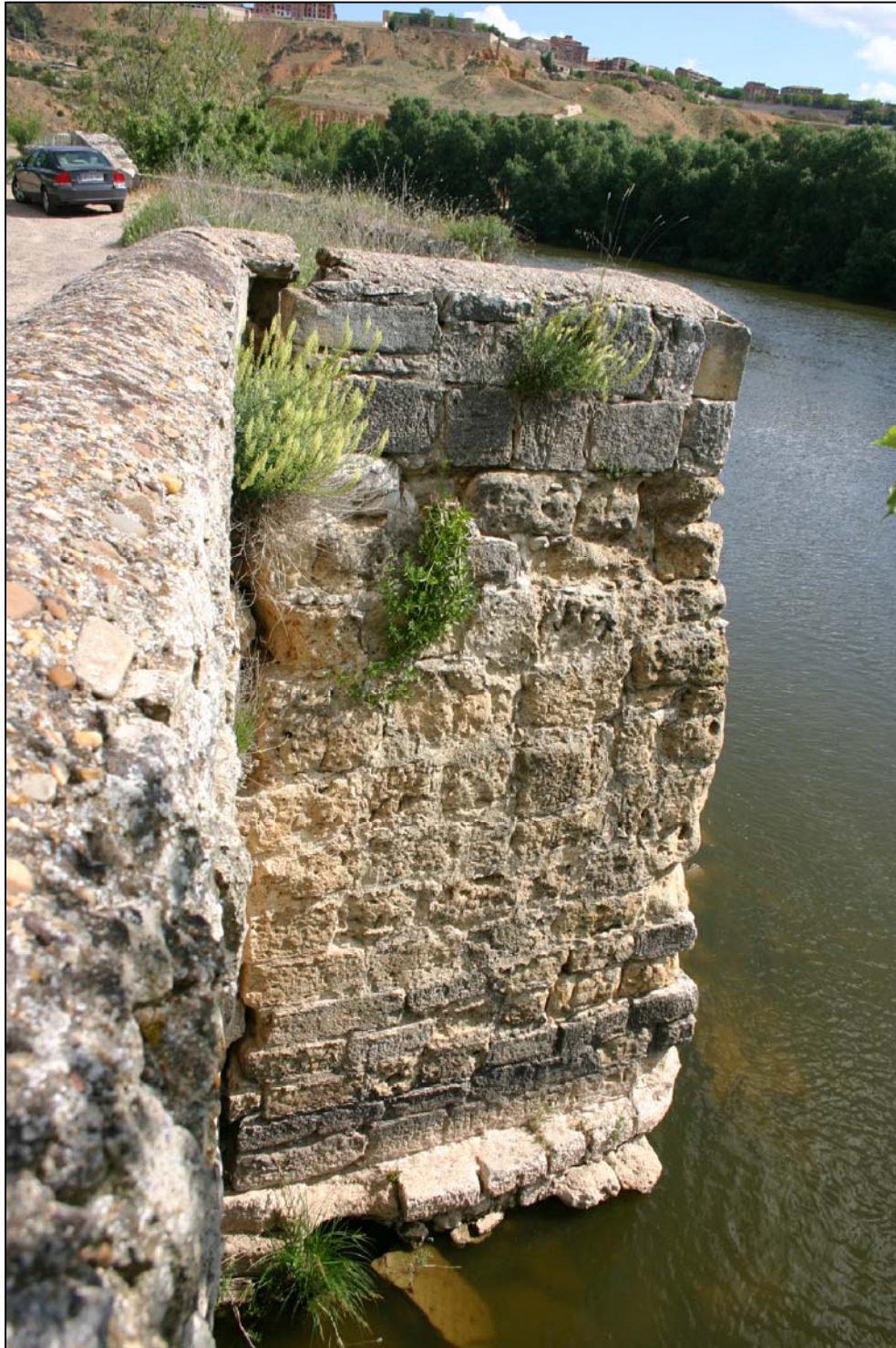
Foto Nº24: Vista frontal del muelle entre el tramo principal y el llamado de Los Cinco Pilares, desde el tablero, sobre el arco S. Se aprecia la grieta de rotura que llega a su punto máximo en la coronación del peto.
