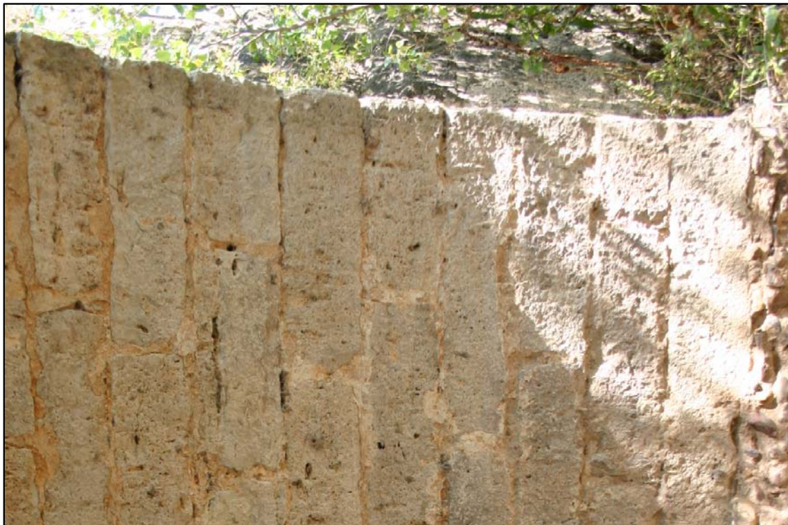
Fotos N°19 y 20: Vista desde los lados norte y sur, respectivamente, de la pila entre los arcos P y R, donde también se aprecia filtrados de agua entre la cara aguas arriba y aguas abajo, de menor entidad que en la pila I-J, pero denotando también un posible lavado de rellenos en su interior.
